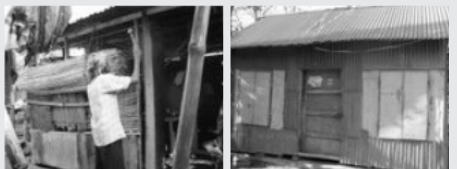
YWCAの支援を受けて家屋の修復をする被災者 修復後の家屋
